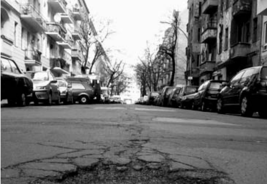
Fahrbahn mit Schikanen: Nach dem Umbau in den kommenden Monaten wird die Kreuzziger Straße ein freundlicheres Gesicht zeigen
